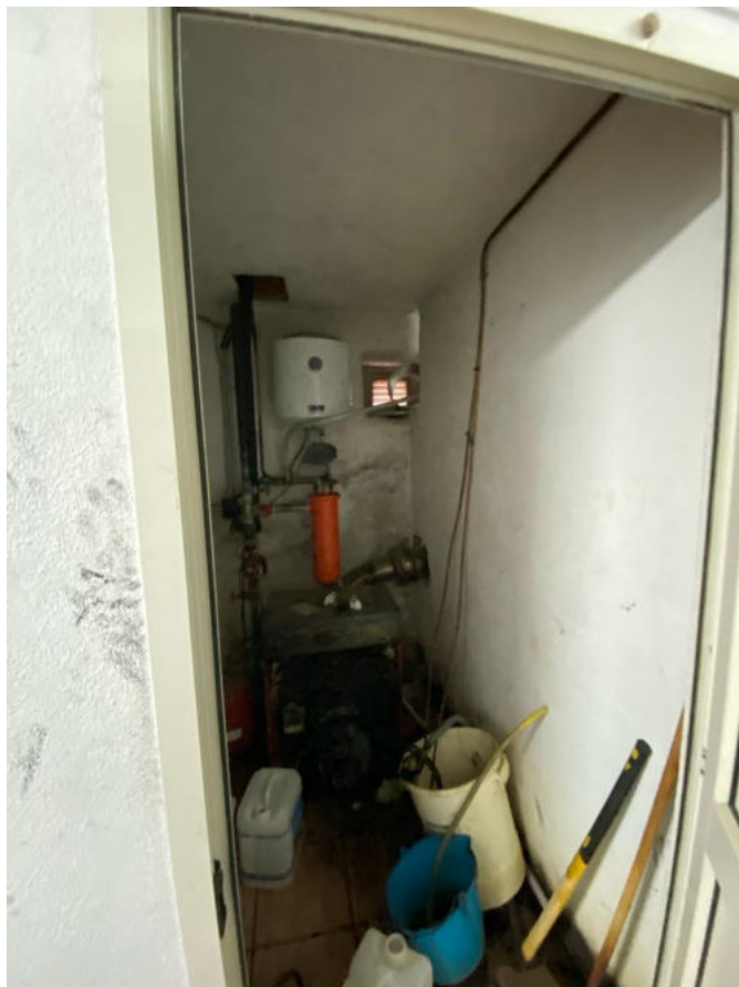
Foto n°43 vano tecnico del magazzino
