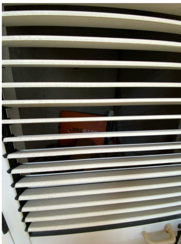
Foto n°6 particolare del locale tecnico
